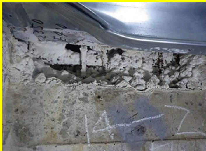
コンクリート打設不良
