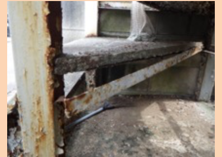
腐食が進んでいる階段
