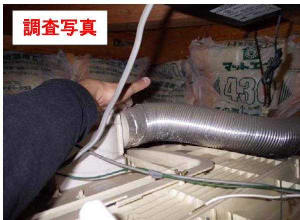
【天井裏空調・換気設備】
