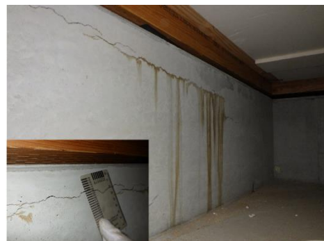
【写真:床下で発見されたひび割れ】
