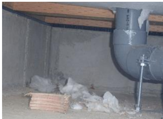
トイレ下部にゴミが残っている様子
