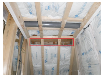
↑断熱材が入っていない事例
