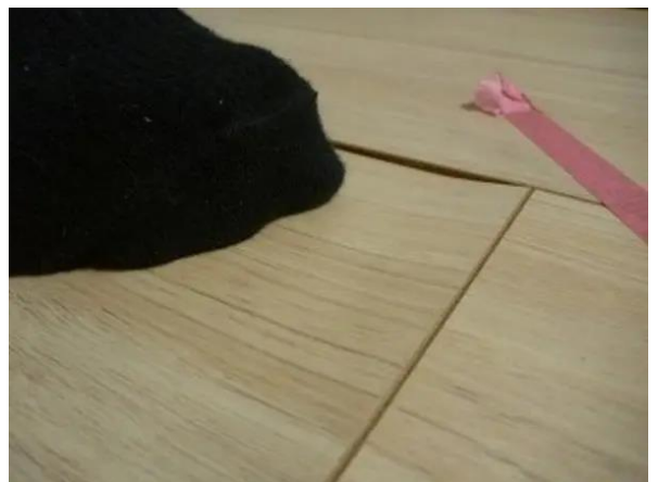
図1 床材が凹んでしまっているようす
