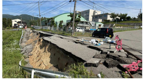
地震後の高台側における地盤の状態（輪島市河井町・2024年5月横山撮影）
