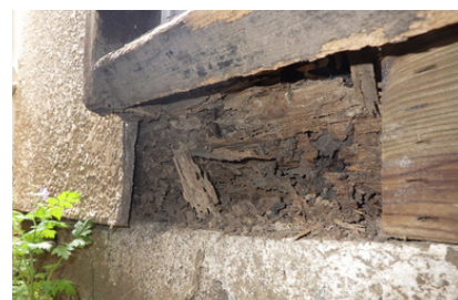
雨漏りにより腐朽した土台
