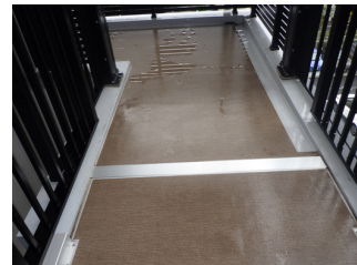
共用廊下の水たまり
