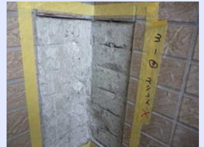
事例② 20か所以上で構造スリット不設置 大規模修繕工事で発覚
