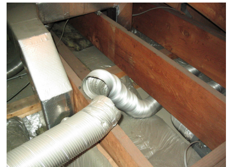
リノベ済み物件の天井裏で発見された、浴室換気扇の排気ダクトが外れている様子
