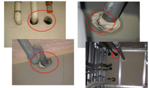
▲防火区画貫通処理の不具合
