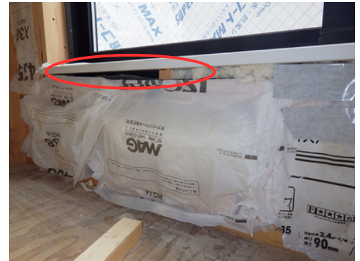
▲窓枠周囲の断熱材に隙間がある
