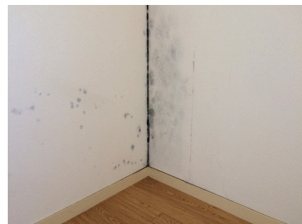
壁の中でカビが発生している
